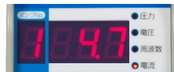
電流表示 (例: 1号ポンプ 4.7A)
