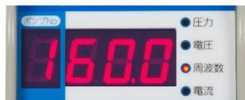
運転周波数表示 (例: 1号ポンプ 60Hz)
